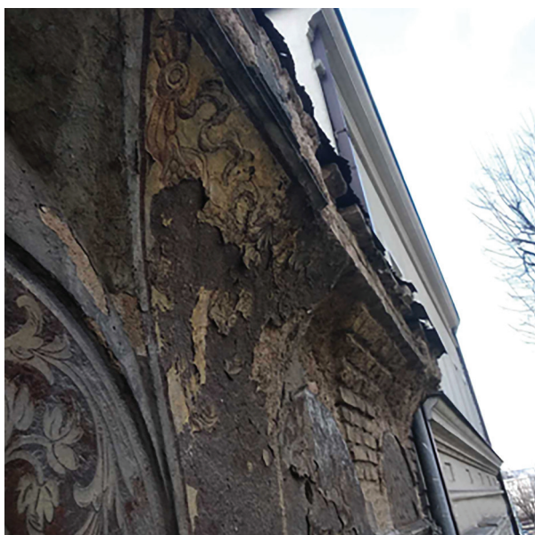
Slika 3. Dio oštećenih pozicija zgrafita ispod simsa i limenog opšava - u vrlo lošem stanju Slika
