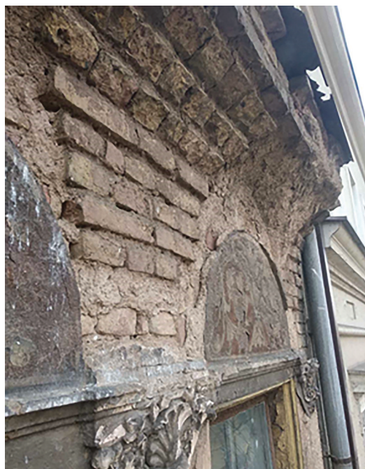
Slika 6. Zid prednje fasade od cigle na kojem se nekada nalazio zgrafito
