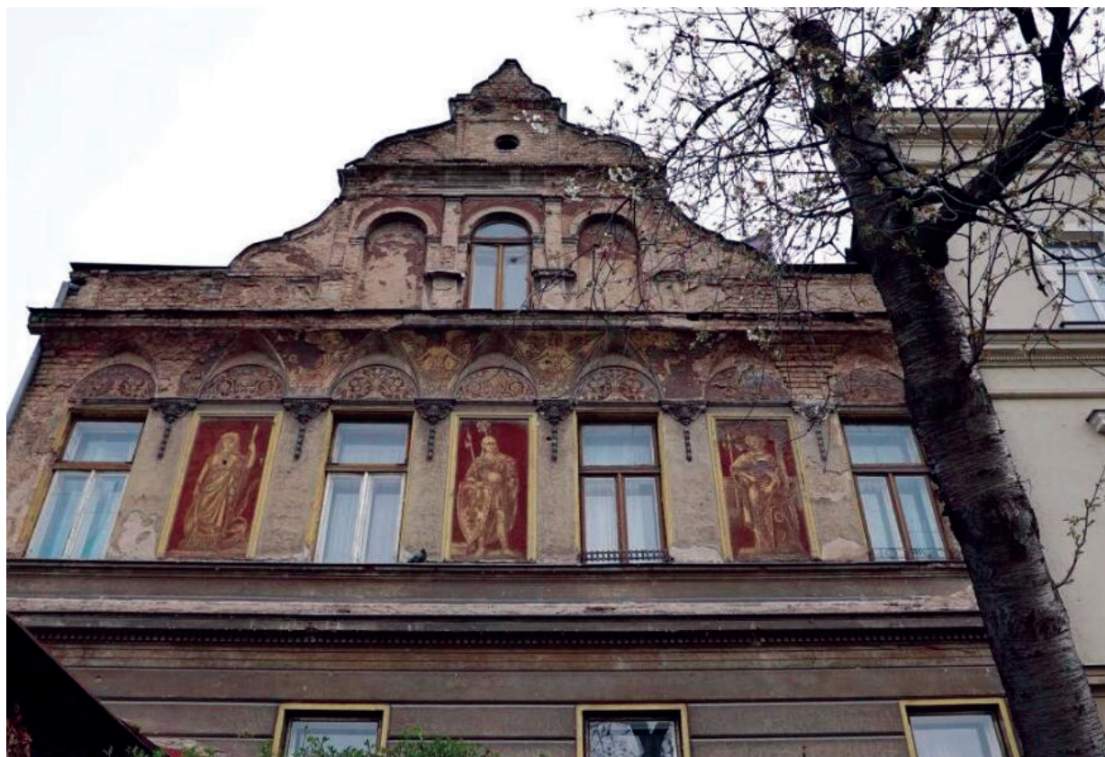
Slika 28. Fasada prije restauracije
