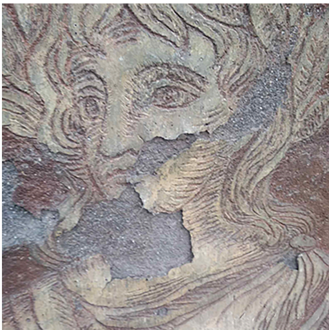
Slika 8. Karakteristično oštećenje, ljuštenje i raslojavanje
