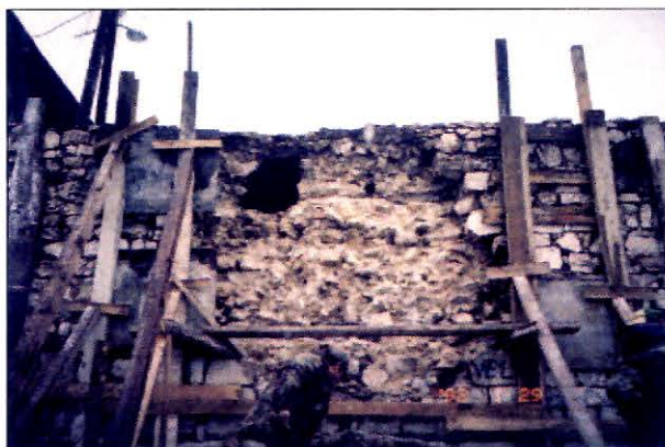
Slika 11. Bedem između kapi - kula, februar – mart 2005.g.- u periodu izvođenja prve faze istražnih radova. Na fotografiji se vidi oštećenje zida u neposrednoj blizini kule Ploča: struktura lica je potpuno osuta, a unutar degradirane površine, uočljiva je i manja kaverna. Kroz otvor nastao obrušavanjem blokova ispune i oplate, vidjeli smo, da u unutrašnjosti bedema, postoji šupljina.
