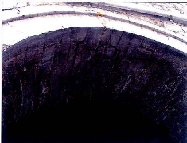
Slika 6. Zasvedeni prolaz kule Širokac, decembar 2004.g.-januar 2005. g.- u periodu izrade projektne dokumentacije. Isprane spojnice i rastresena struktura čeonog luka od krečnjačkih klesanaca, te raspadanje sedrenih blokova, karbonizacija i „divlja patina“ na podgledu svoda.
