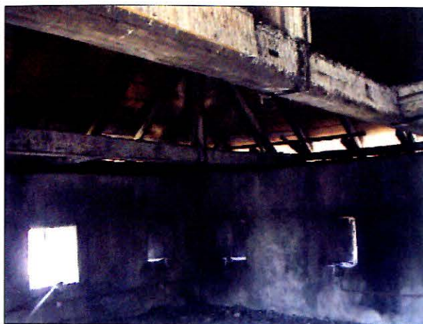
Slika 7. Unutrašnjost kule Ploča, decembar 2004.g.-januar 2005.g.- u periodu izrade projektne dokumentacije. Može se uočiti da su zidovi potpuno prekriveni cementnim malterom.
