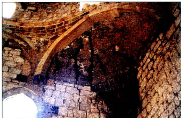
Sl.6 – Pogled na velika oštećenja trompe koja se nalazi u neposrednoj blizini minareta
