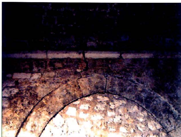
Slika 8. Unutrašnjost kule Ploča, decembar 2004.g.-januar 2005.g.- u periodu izrade projektne dokumentacije. Jedna od kontinuiranih pukotina u svodu kule.
