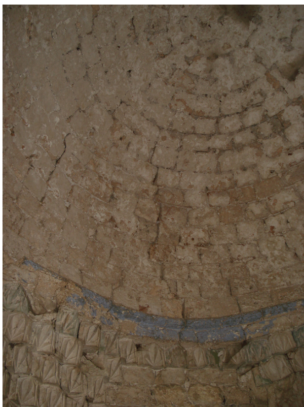
Slika 20., Pukotine na unutrašnjoj strani zidova i kupole
