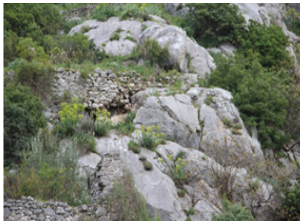
Zidovi srušenih kuća su destabilizirani i bez konstrukcijske potpore
