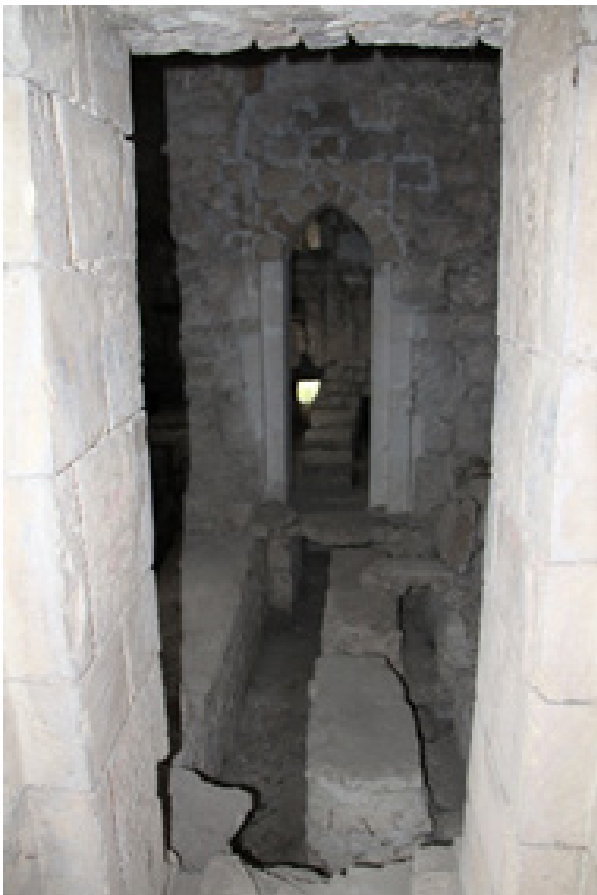
Unutrašnjost hamama sa konstruktivnim oštećenjima
