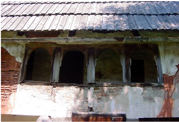
Detalj prozora, zatečena oštećenja
