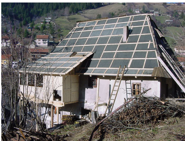
Završni radovi rekonstrukcije konstrukcije objekta i verande. Ugrađena pokrovna daska sa ljepenkom kao podloga za ugradnju šindre
