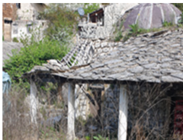
Trijem medrese je urušen u vrlo opasnom stanju kolapsa
