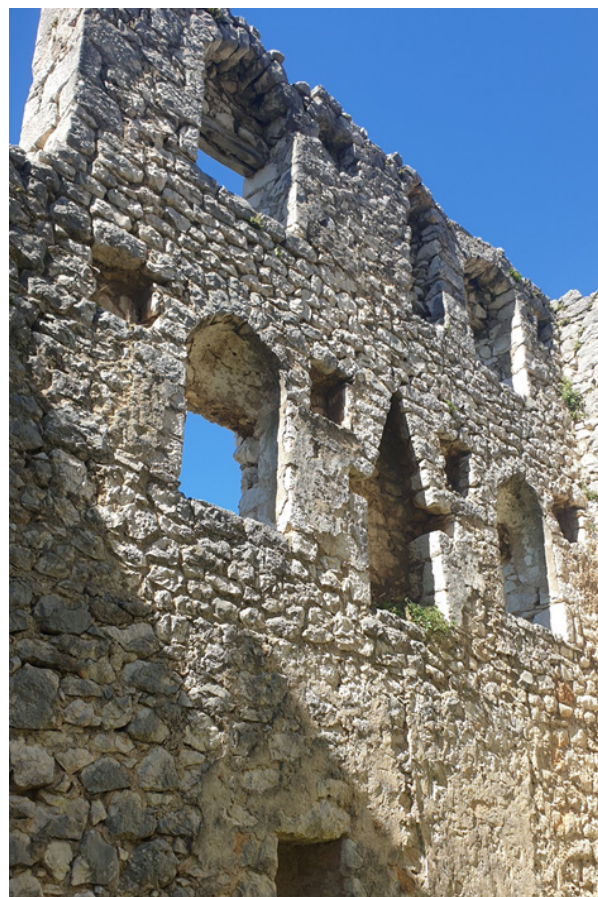
Kruna zida i otvori destabilizirani
