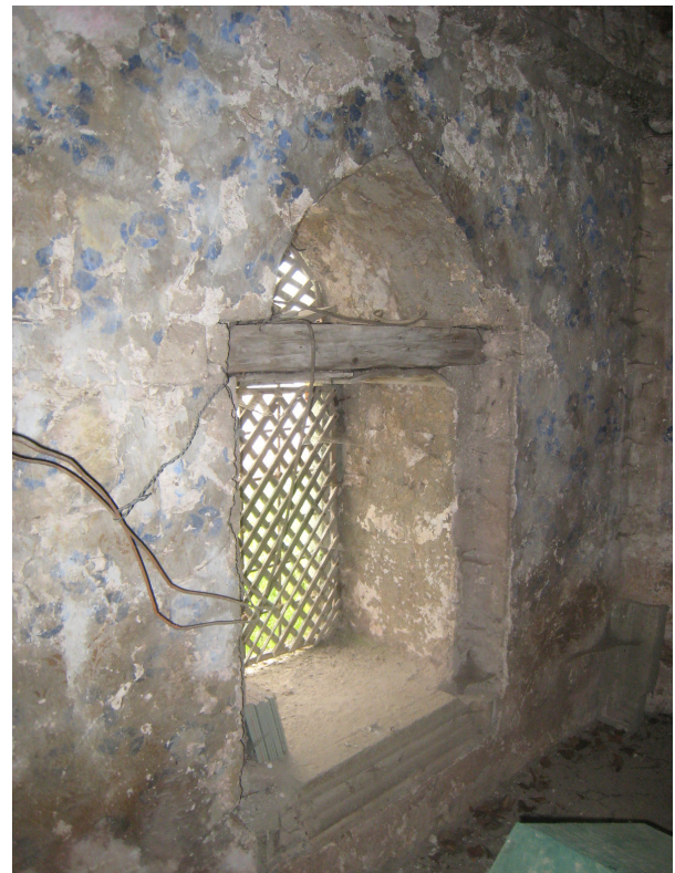
Sl. 15 Prozori bez stolarije zatečeni su samo drveni mušebci.
