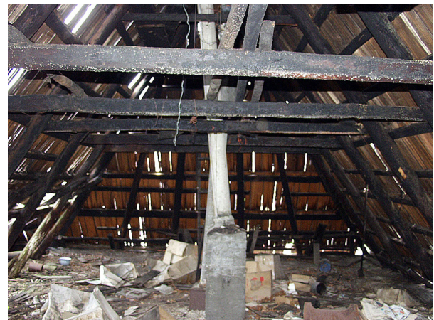
Zatečeno stanje krovne konstrukcije
