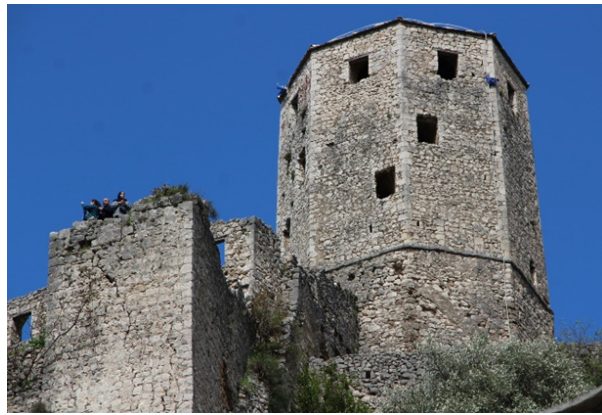
Vanjski južni zid sa destabiliziranom krunom i vertikalnom pukotinom.
