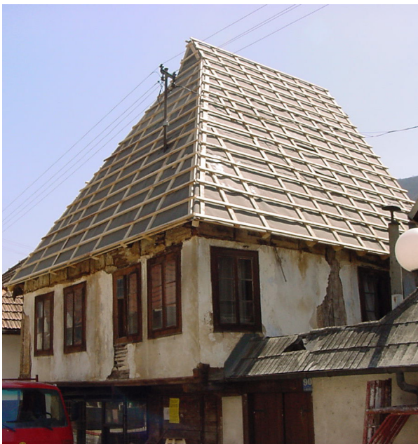
Završni radovi rekonstrukcije konstrukcije objekta. Ugrađena pokrovna daska sa ljepenkom kao podloga za ugradnju šindre.
