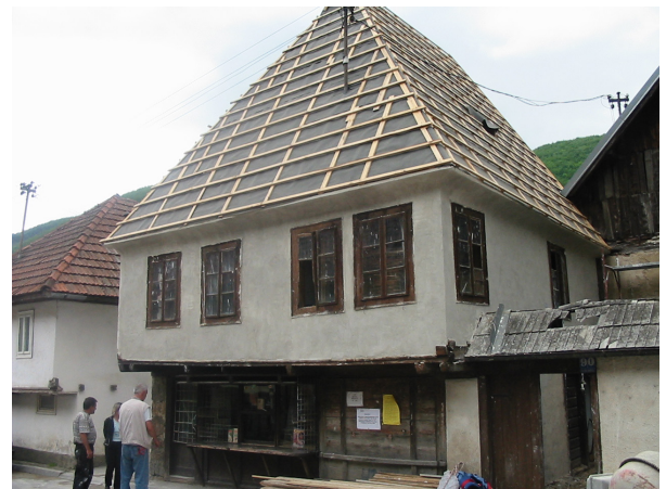
Završni radovi malterisanja sprata i rekonstrukcije konstrukcije objekta. Ugrađena pokrovna daska sa ljepenkom kao podloga za ugradnju šindre.
