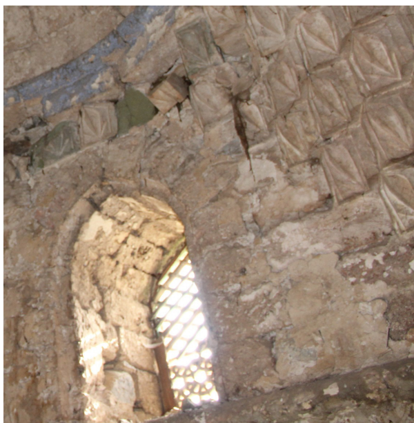
Slika 22., Pukotine u području prozorskih otvora i oštećenja trompi i unutrašnjeg vijenca
