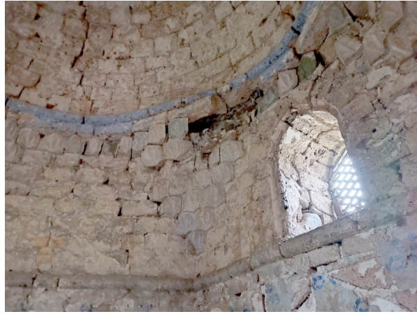
Sl. 9 Zatečena oštećenja mukarnasa 2024.godine
