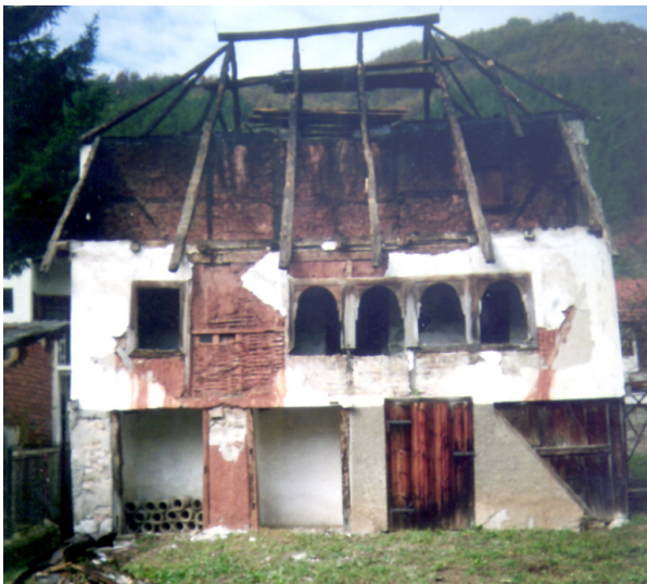
Vidjiva oštećenja na fasadi (bondruk od šepera)
