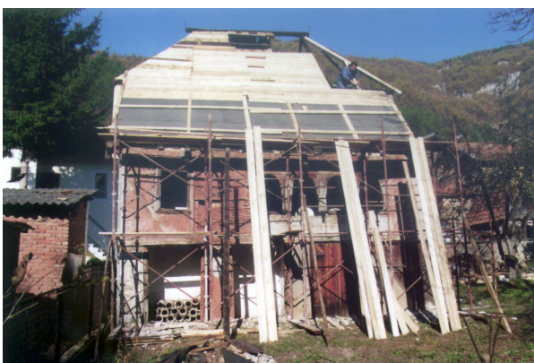
Konsolidovana krovna konstrukcija i ugradnja pokrovne daske sa ljepenkom kao podloge za ugradnju šindre
