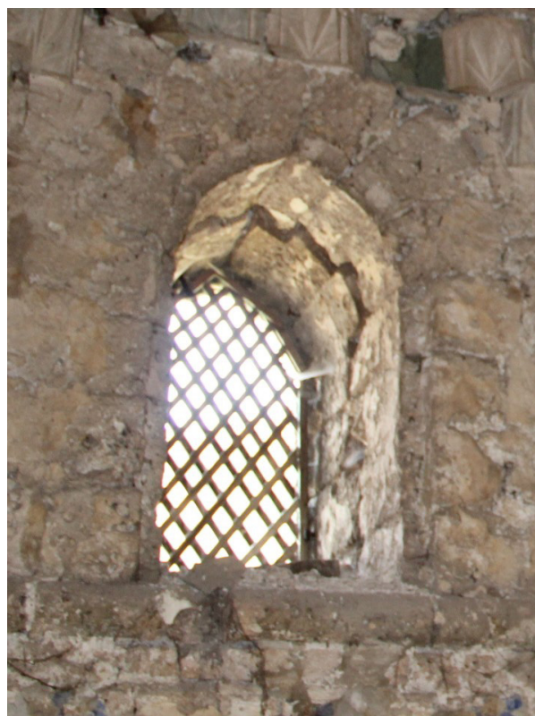
Slika 21., Pukotine u području prozorskih otvora
