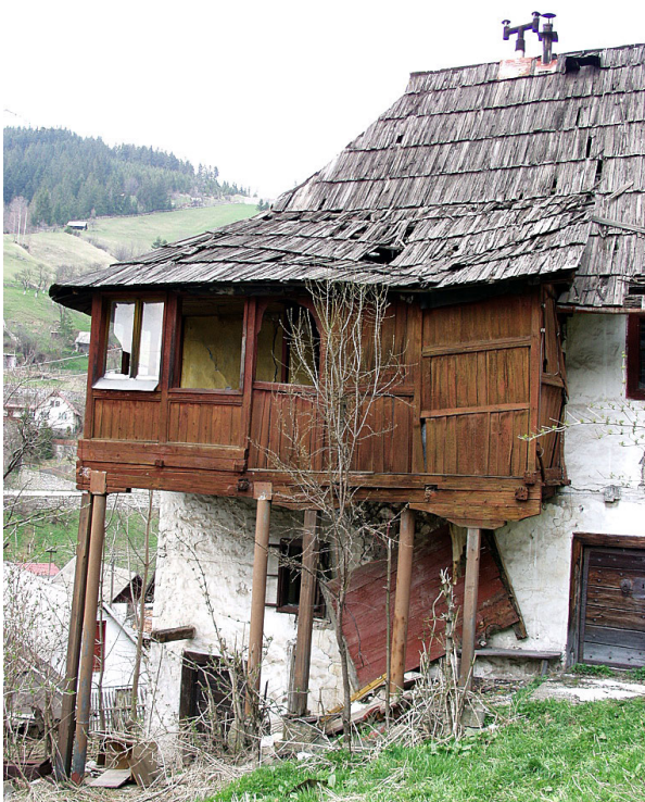
Zatečeno stanje verande
