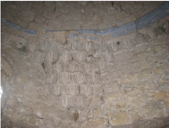
Sl. 10 Oštećenja na dekorativnom vijencu, zatečeno stanje 2010.godine
