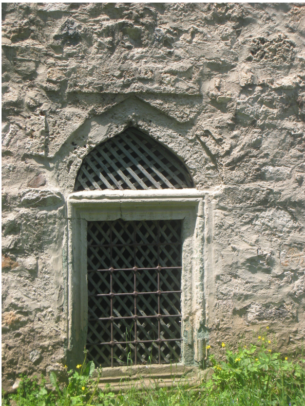
Sl. 14 Donji prozori sa ukrasnim vanjskim i unutrašnjim profilisanim doprozornicima i demirima od kovanog željeza
