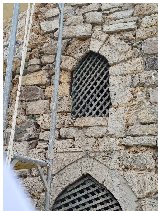
Sl. 19. Ugrađeni nedostatni kameni blokovi
