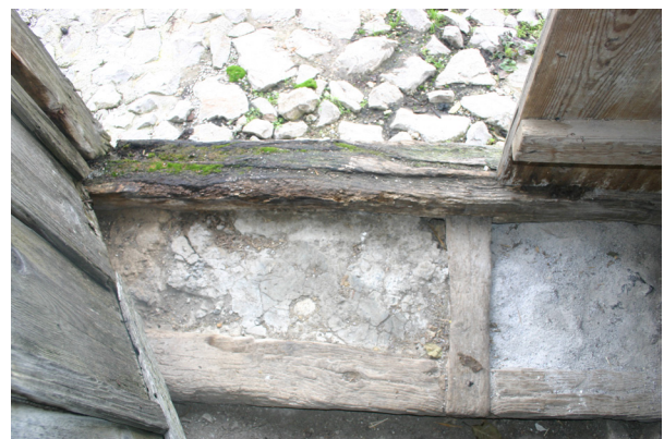
Fotografije ulazne kapije sa oštećenjima, snimljeno tokom 2015. i 2016. godine, Izvor: Azra Tunović
