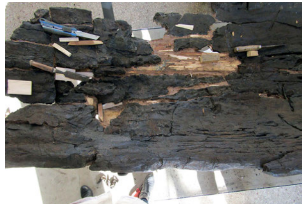
Mastik aralditom i komadima drveta na velikim pukotinama
