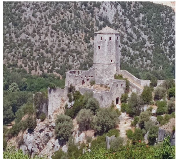
Gavrankapetanovića kula - oštećenje konstrukcije
