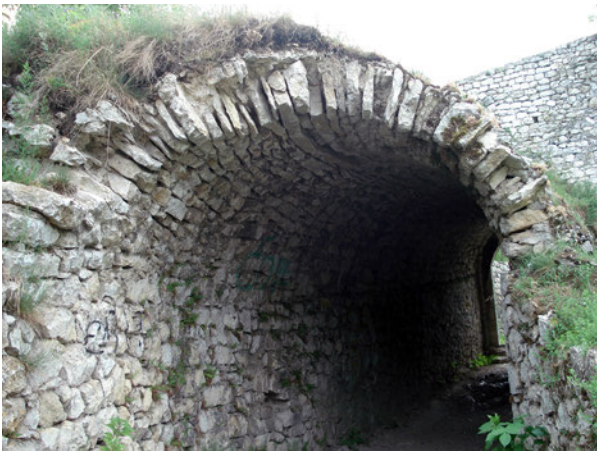
Ulaz u tunel, zatečeno stanje
