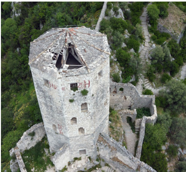
Gavrankapetanovića kula - oštećenje pokrova
