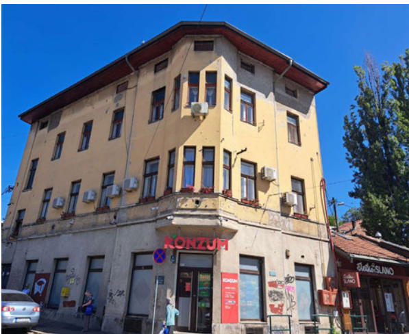
Fasada na objektu u ulici Safvet-bega Bašagića 2-4, zatečeno stanje
