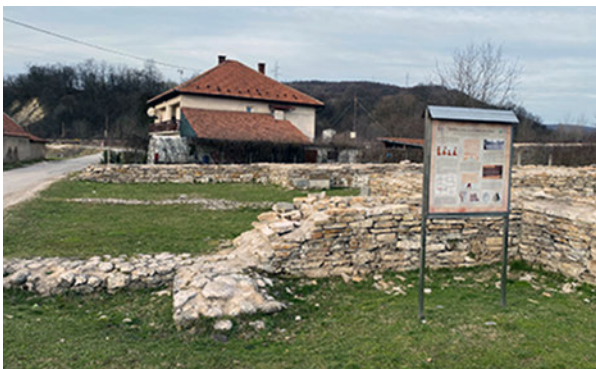
Pogled na lokalitet sa južne strane: stariji zid crkve zidan oblicima obrastao mikrolitoflorom i destabilizirani zid III.l.u blizini kojeg je neadekvatna informacijska tabla; 2020.g., Foto: Azra Tunović
