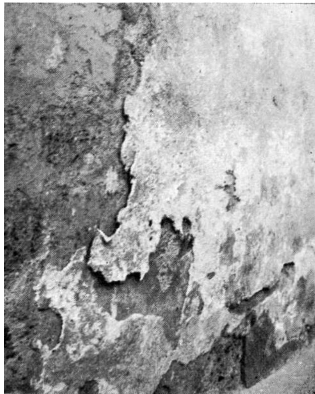
Sl. 15 Primjer upropaštenog maltera na kome je izveden lijevi »mihrab« u trijemu Aladže
